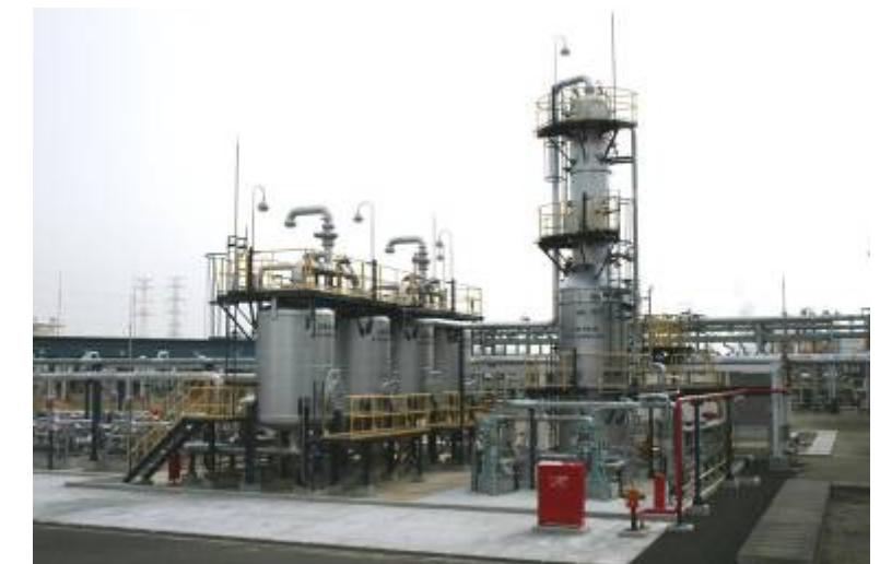
陸上出荷炭化水素ベーパー回収装置
