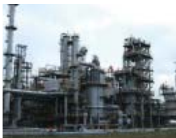
サルファーフリーガソリン製造設備
