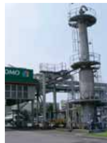
炭化水素回収装置
