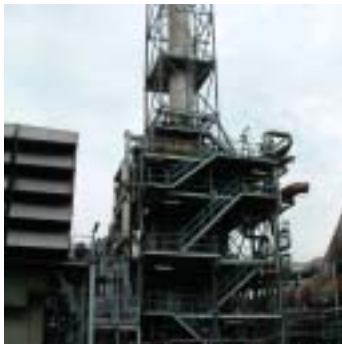
ボイラー廃熱回収装置
