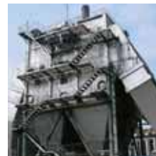
電気集塵装置
