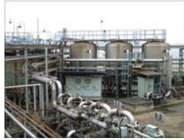
※2活性炭吸着設備
