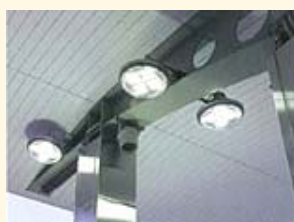
大型化したキャノピー柱と LED照明
