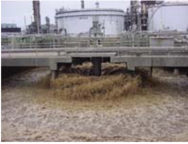
※1活性汚泥処理設備
