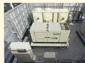
貯水槽、発電機と エネファーム
