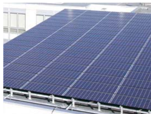
集合住宅に設置した太陽光発電システム
