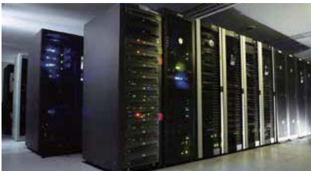
サーバールーム
