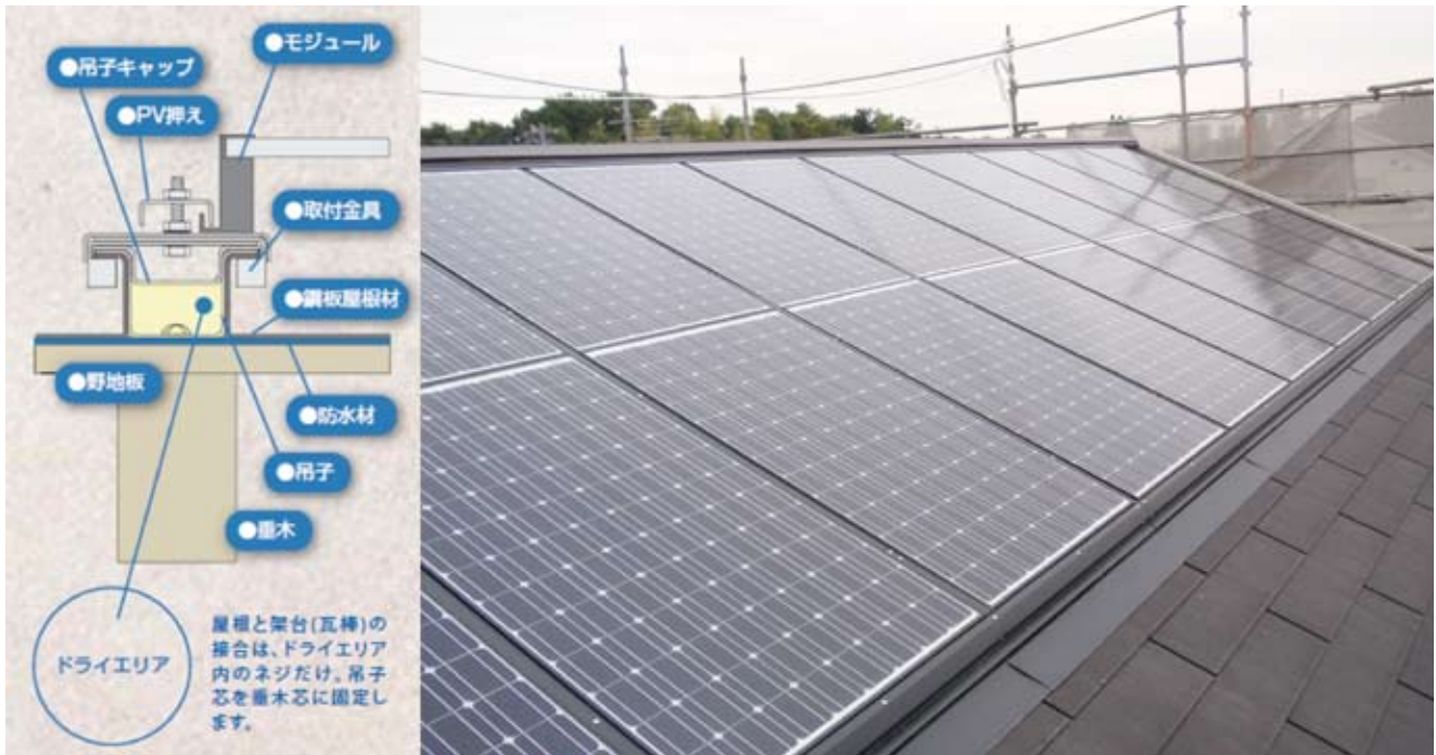
屋根組込型太陽光発電システム設置例
