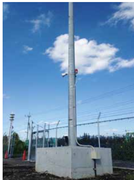
かすみがうらメガソーラーの掘削 50cm 以内の電柱
