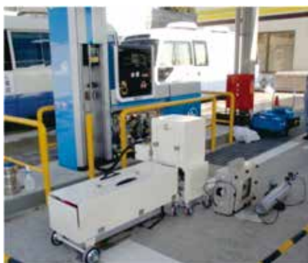
図2 高圧ガスサンプリング装置
