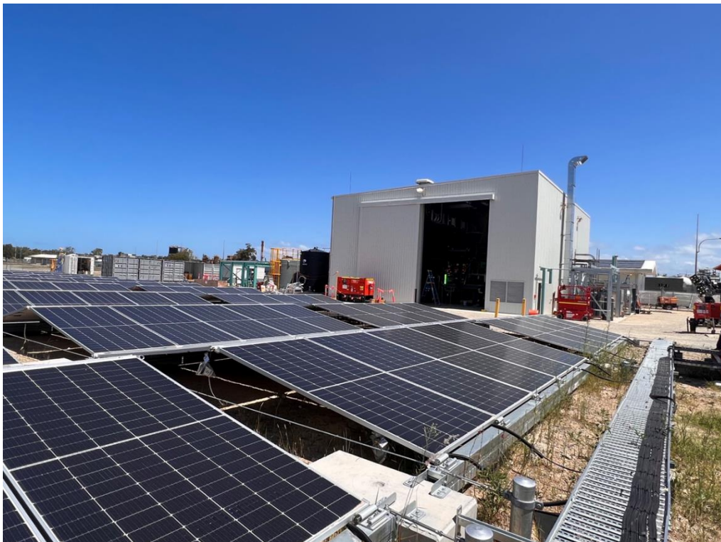
プラント外観
