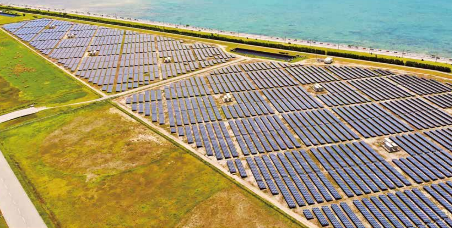
うるまメガソーラー発電所
