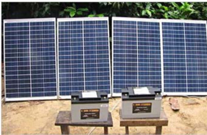
(写真1)新たに設置したソーラーパネル4枚とバッテリー2台 ©WCSコンゴ共和国
