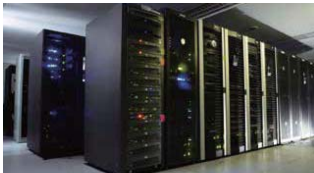
サーバールーム
