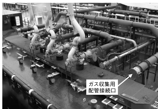
写真5 タンカー原油受払作業用配管接続状況
