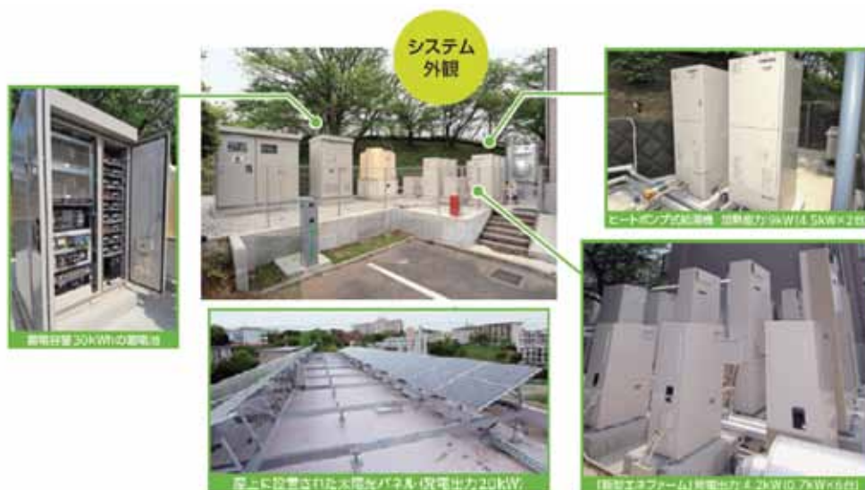
図2 エネルギーシステムの外観
