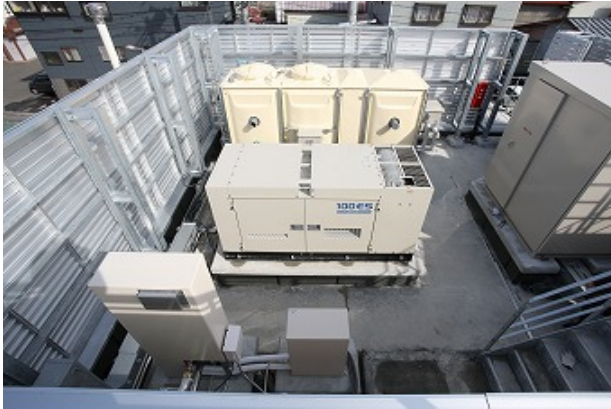
貯水槽、発電機、エネファーム
