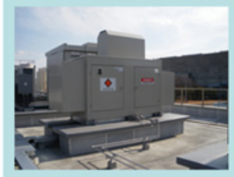
エンジン発電機
