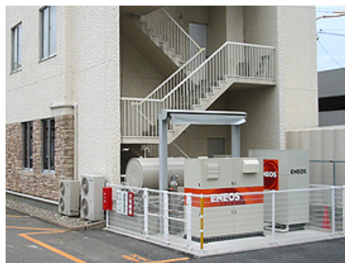
灯油仕様10kW級燃料電池 設置場所
