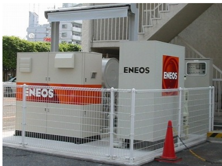
広島ダイヤモンドホテルに設置されている灯油仕様10kW級業務用燃料電池システム
