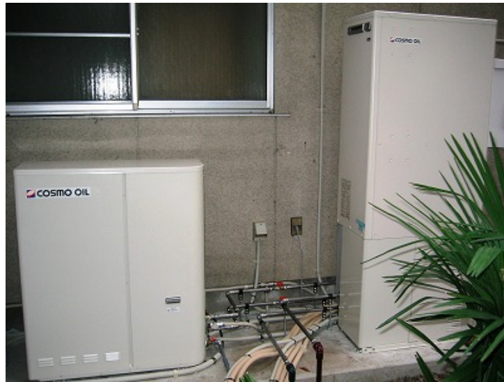
ご家庭に設置された燃料電池
