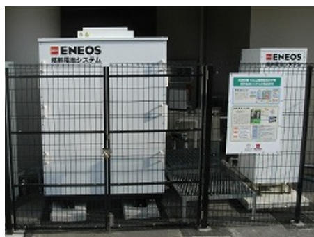
運転開始した燃料電池システム
