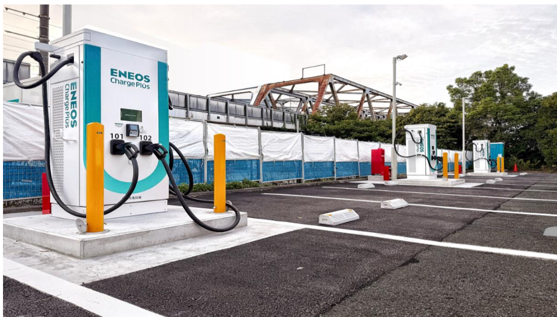
（大井充電ステーションの現地状況）
