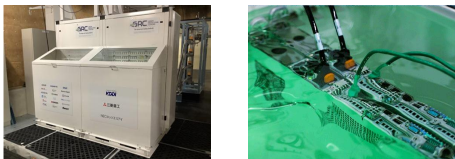
システム全体(左)とサーバーが冷却液に浸漬している状態(右)
