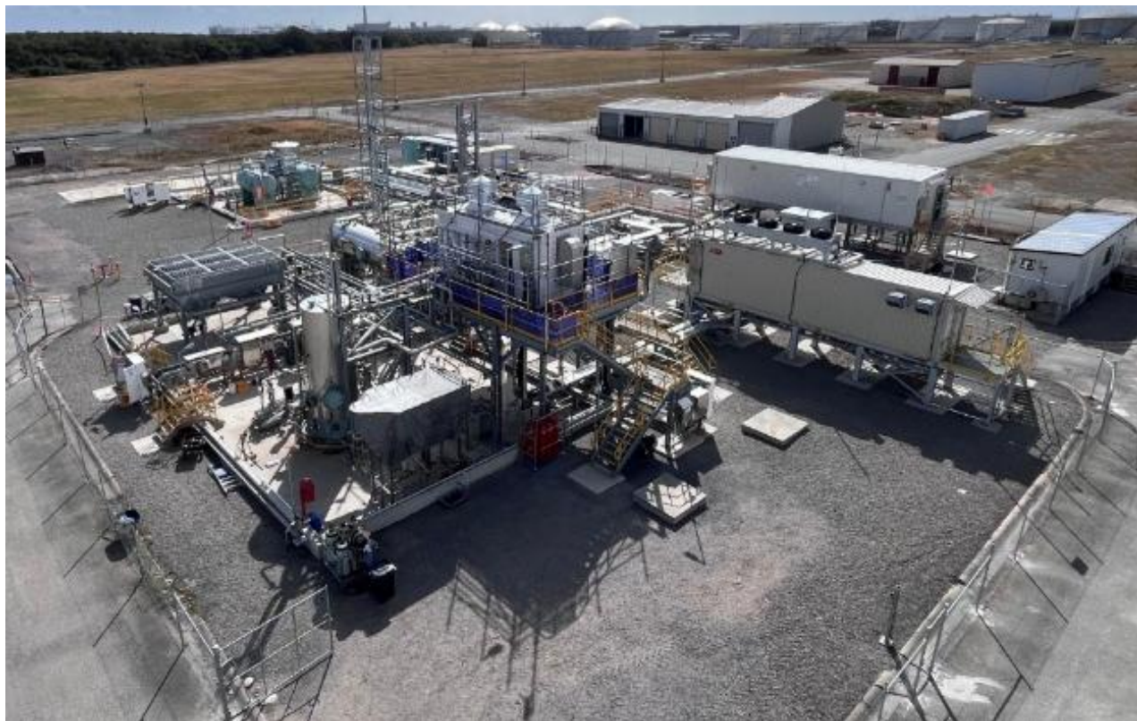
プラント外観
