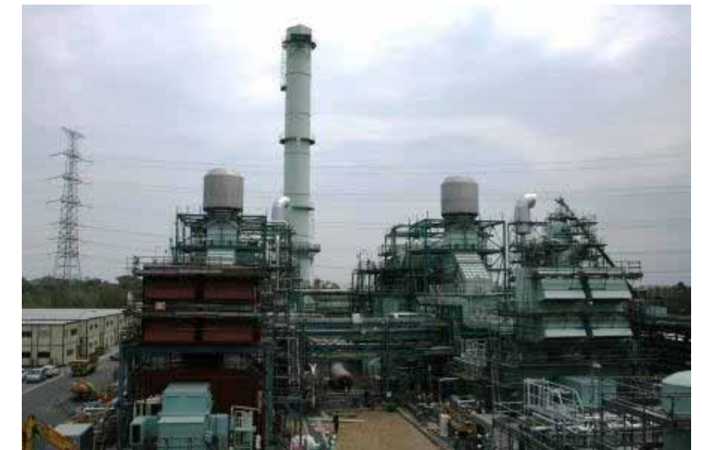
新設発電装置
