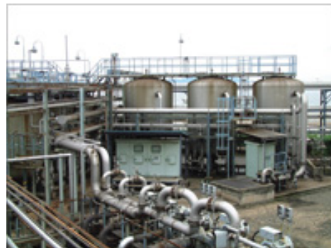
※2 活性炭吸着設備
