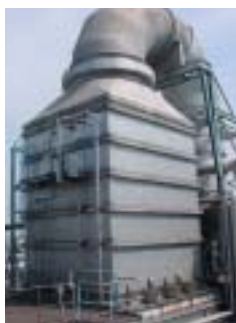
排煙脱硝装置
