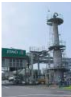
炭化水素回収装置
