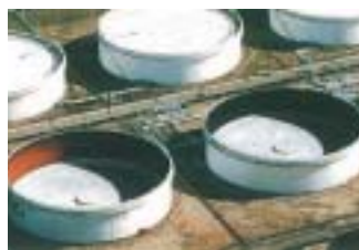
浮き屋根タンク
