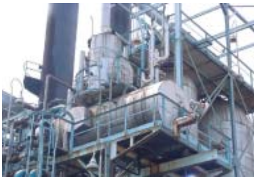
改質装置用廃熱回収装置
