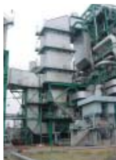
排煙脱硝装置
