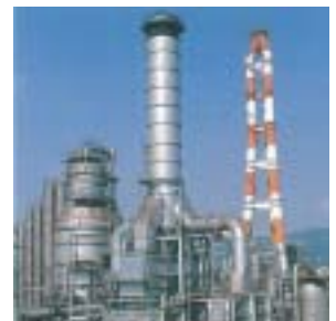
間接脱硫装置
