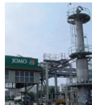
碳化氢回收装置
