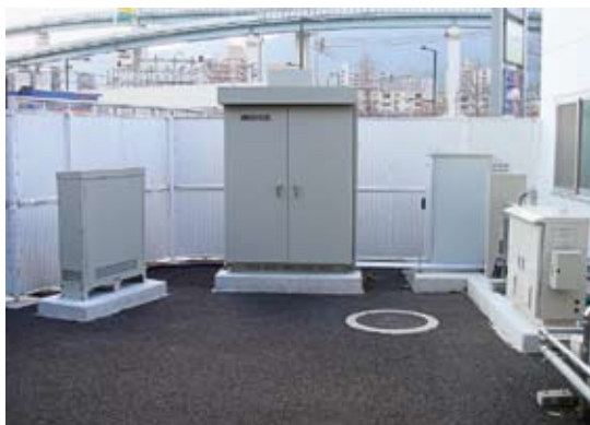
停電時バックアップシステム実証試験の水素型燃料電池、蓄電池等（北九州水素ステーション内に設置）
