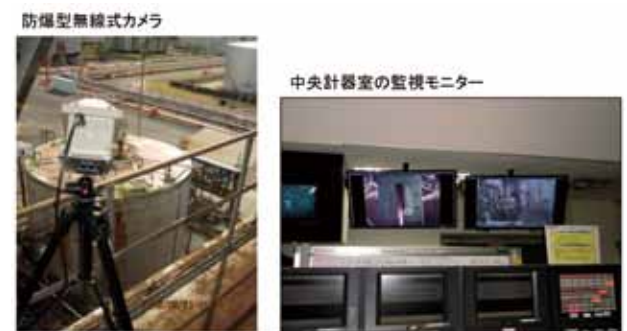
図 8 【無線 LAN 活用例】防爆型無線式カメラ (IP カメラ)
