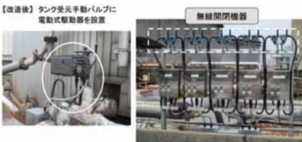
図 6 【無線計装導入例】バルブの遠隔操作化 その②
