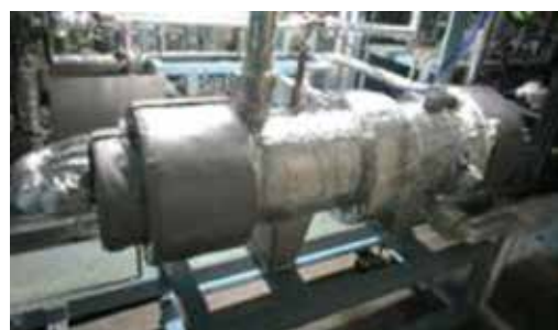
図 8 ベンチ装置へ接続した 24 本組モジュール
