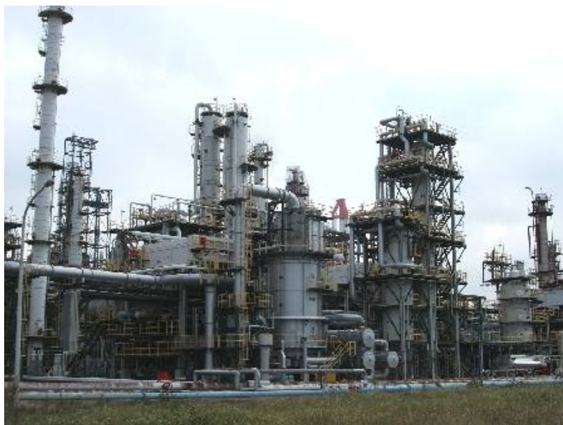
今回竣工した「サルファーフリーガソリン製造設備」(名称:第6水素化脱硫装置)
