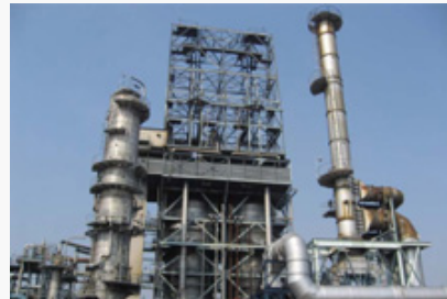
「重質油熱分解装置」の全体写真
