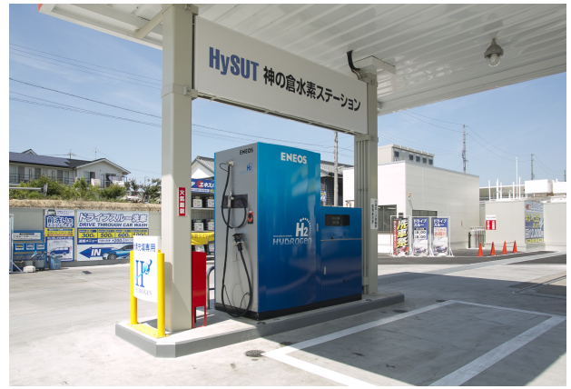
ガソリンスタンド計量機と並列設置された水素充填機
