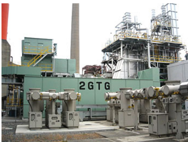
麻里布製油所に建設されたガスタービンジェネレーター
