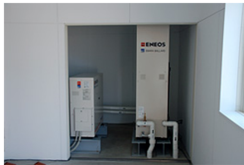
設置された燃料電池
