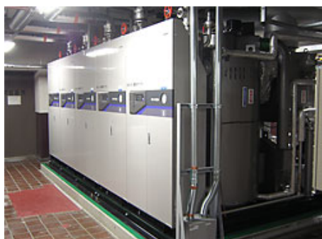
新日本石油ビルへ導入された低NOxボイラ
